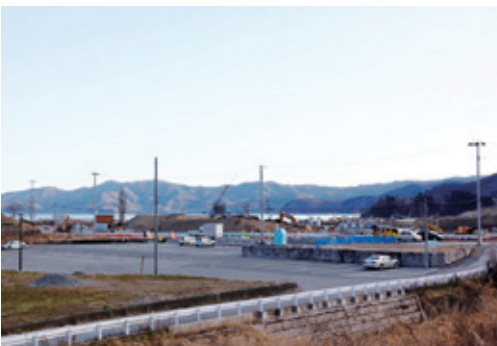
復興工事が進む越喜來地区。まちの姿は刻々と変わっていく。
